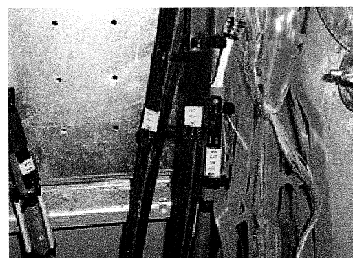
Kabel och tubmärkning
